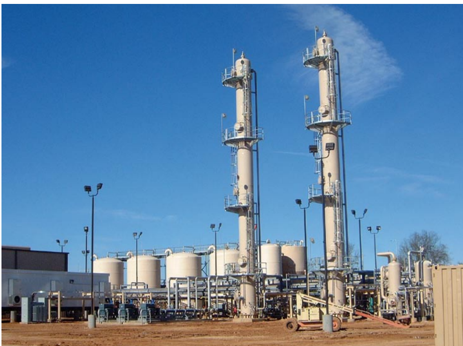
Instalacja odsiarczania z wykorzystaniem procesu biologicznego firmy Paqell, stan Teksas, USA
