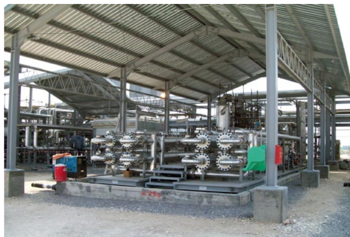
Skid membranowy FuelSep firmy Membrane Technology and Research w Newark w Kalifornii, zainstalowany w Indonezji. Odsiarczony gaz jest jeszcze doczyszczany za pomocą neutralizatora
