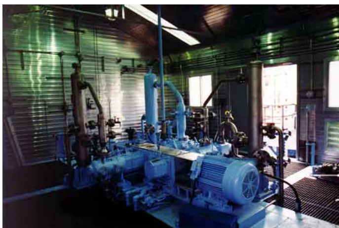
Sprężarka gazu kwaśnego (projekt West Culp, Alberta)
