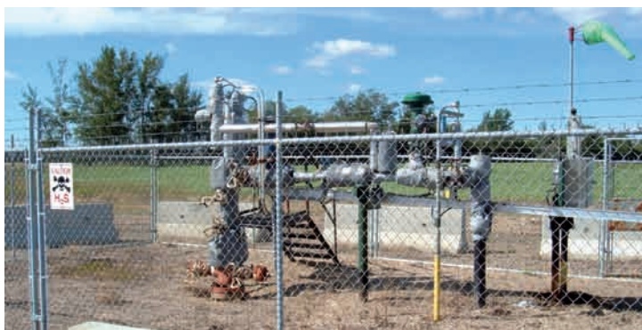
Głowica odwiertu do zatłaczania gazu kwaśnego, Rycroft w północnej Albercie
